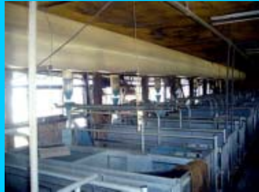
暑熱対策としてダクトを利用
